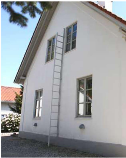
Fluchtleiter am Haus Escape Ladder at the house
